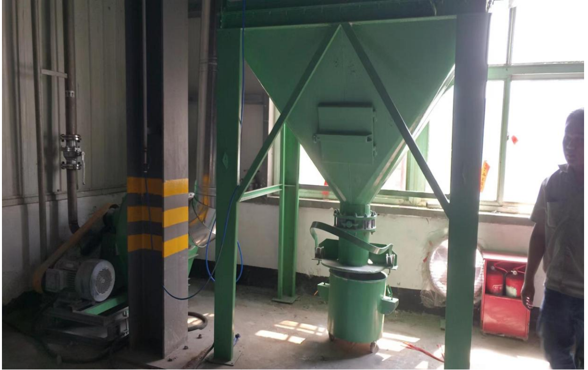
图 4-2 新建布袋除尘器
