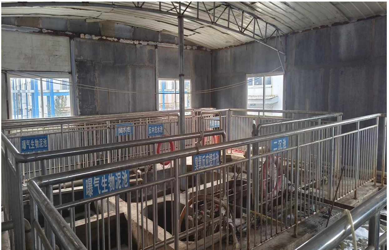
图 6-2 巴德士现有厂区污水处理站
